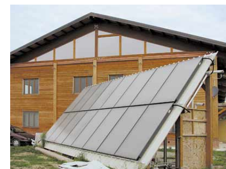
Impianto solare piano combinato (acqua calda sanitaria e riscaldamento)
