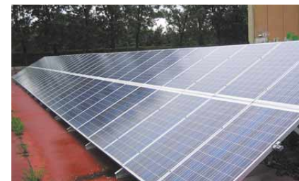
impianto fotovoltaico a terra
