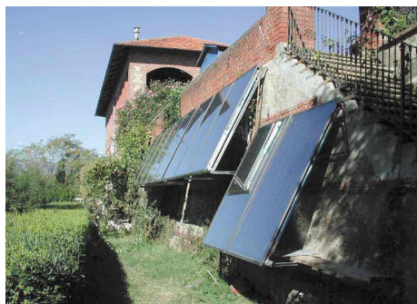
impianto solare piano
