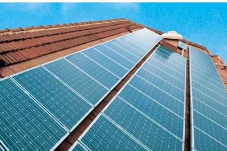
impianto fotovoltaico parzialmente integrato
